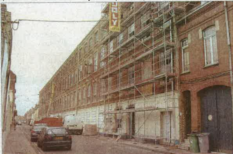
La façade de 102 mètres de long a été conservée et retapée. Les fenêtres seront toutes en bois.
